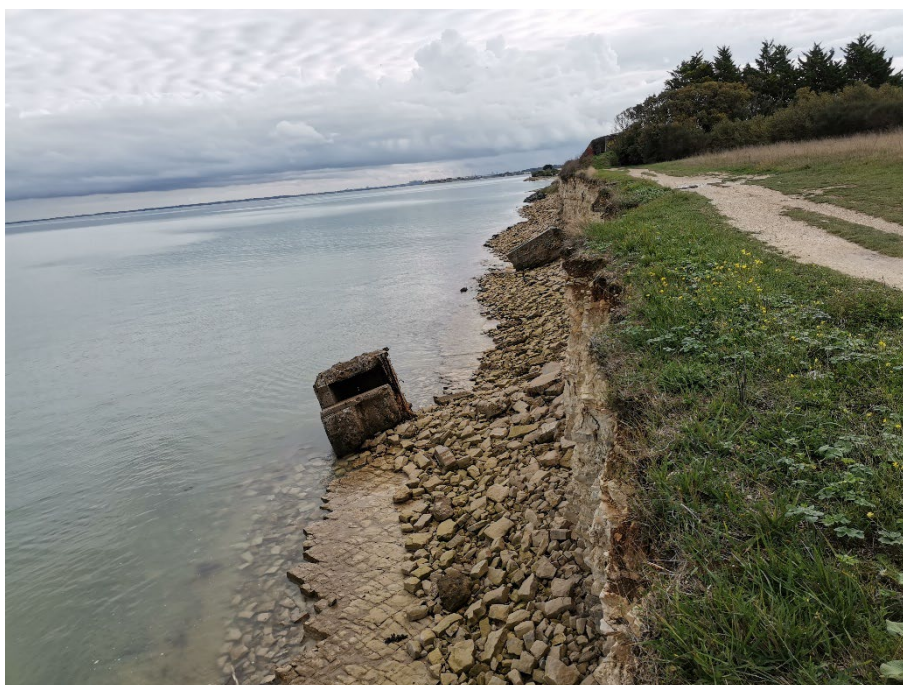
Figure 12 - Falaises situées à l'ouest de la commune le 23/10/2023. © CdC Ile de Ré
