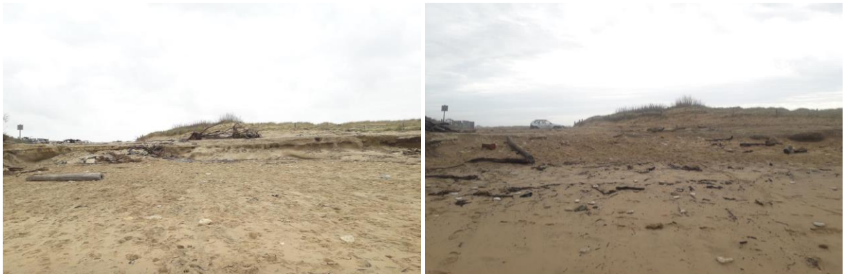
Figure 11 - Accès plage de Grand-Village-Plage le 02/12/2022 (gacuhe) et le 13/03/2023 (droite). © Observatoire de la côte de Nouvelle-Aquitaine
