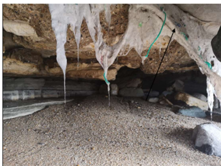
Figure 11 - Cavité observée sous le perré de haut de plage de Bidart Centre, suite aux fortes houles de février 2020 (source : rapport Géolithe 19-089_I_3_o_Note_urgence, daté 19/02/2020)
