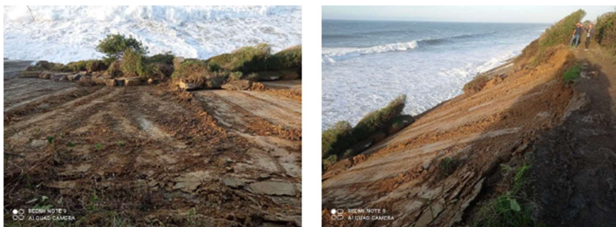
Figure 20 - Vues, depuis le sentier du littoral, de la surface de rupture et du banc glissé démantelé ; clichés datés du 30/10/2020 (©CAPB) (extrait note OCA NT_BDX-2020-020)
