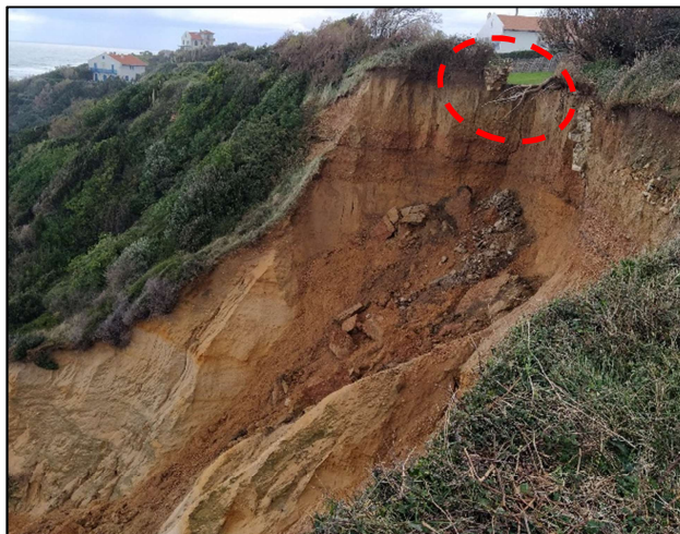
Figure 8 - Premiers désordres sur le mur maçonné en tête de falaise, suite au décrochement initial, observé le 08/12/2020 (cliché mairie de Bidart), au niveau de la Falaise de la Corniche
