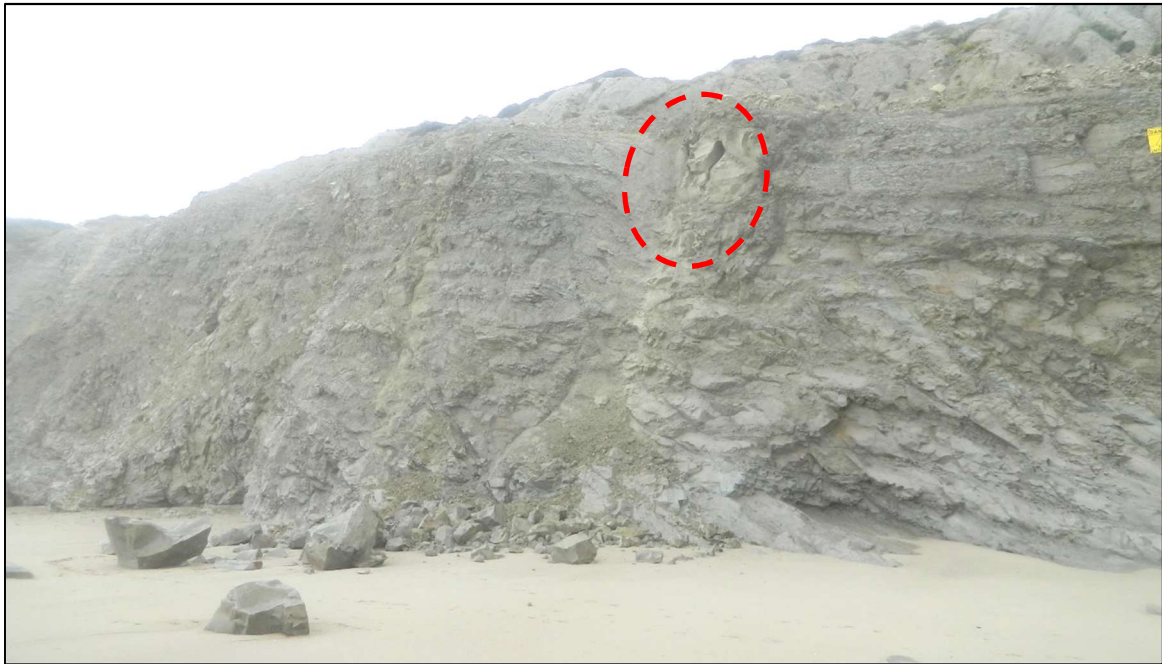
Figure 4 - Eboulement d'une dizaine de m 3 de matériaux, à l'automne 2020 ; identification de la zone de départ à une vingtaine de mètres au-dessus de la plage (cliché 05/10/2020 ; ©Observatoire de la Côte Aquitaine)
