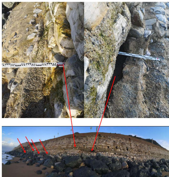
Figure 10 - Sous-cavage et cavités relevés en pied de mur de haut de plage, de Bidart Centre, suite aux fortes houles de février 2020 (source : rapport Géolithe 19-089_I_3_o_Note_urgence, daté 19/02/2020)
