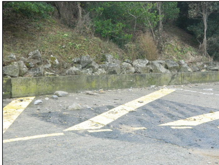
Figure 1 - Dépôts par submersion marine, en arrière de la jetée des Alcyons
