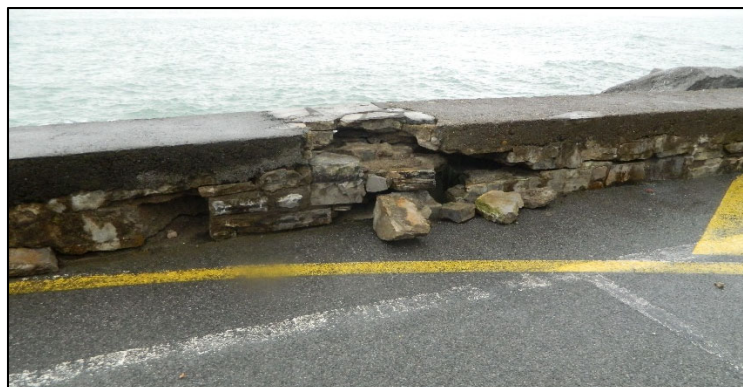
Figure 3 : Désordres localisés sur le parapet de la jetée des Alcyons
