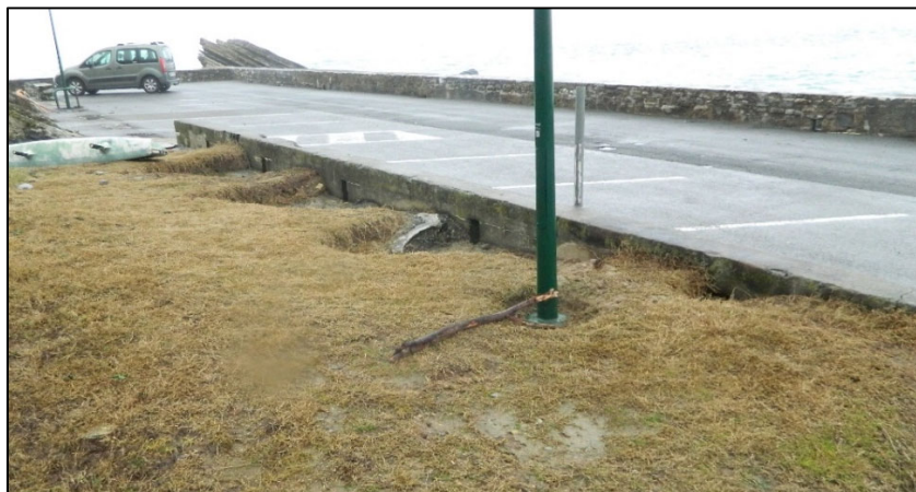
Figure 2 - Ravinement au droit des barbacanes, par retour des eaux de surverse, au-dessus de la jetée des Alcyons
